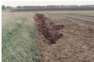
Рис. 6. Этапы проявления линейной водной эрозии (фото А.В. Евтюшкина)
